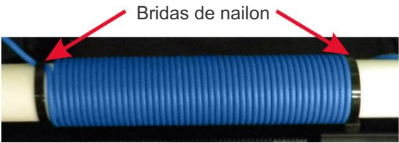
Ejemplo de una tubería correctamente envuelta. ¡No se permiten huecos ni envolturas de cables sueltas!
