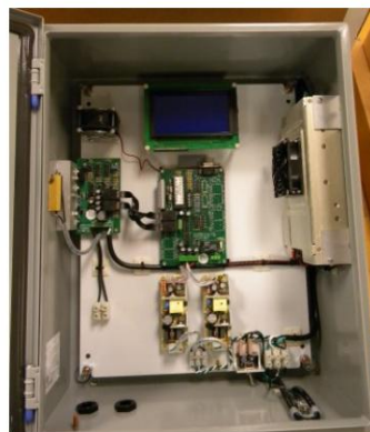
Unidad de control con puerta abierta mostrando la electrónica en el interior
