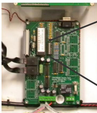
Vista del tablero maestro que muestra Ubicación del interruptor DIP
