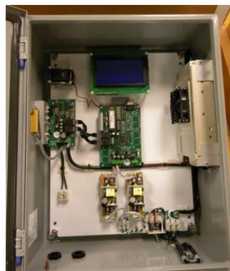
Unité de commande avec porte ouverte montrant l'électronique à l'intérieur
